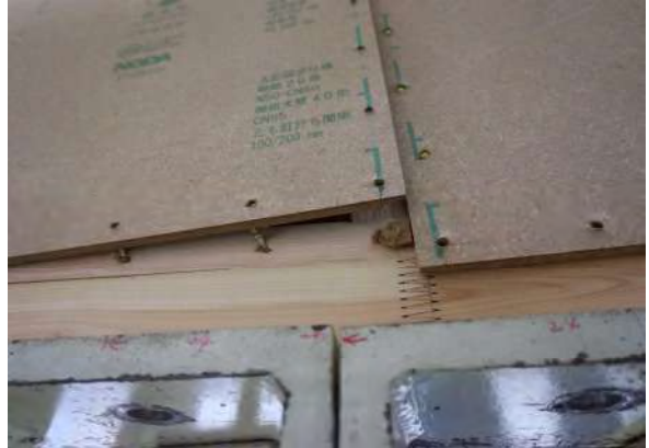
ウラ側面材継手部 面材くぎの引抜け
