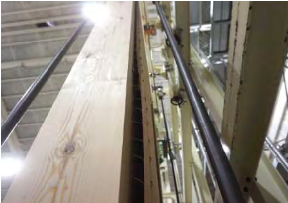
右面材ウラ側 面材くぎの引抜け
