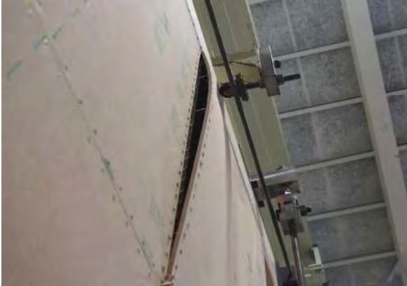
オモテ側面材継手部 面材くぎ頭のパンチングアウト
