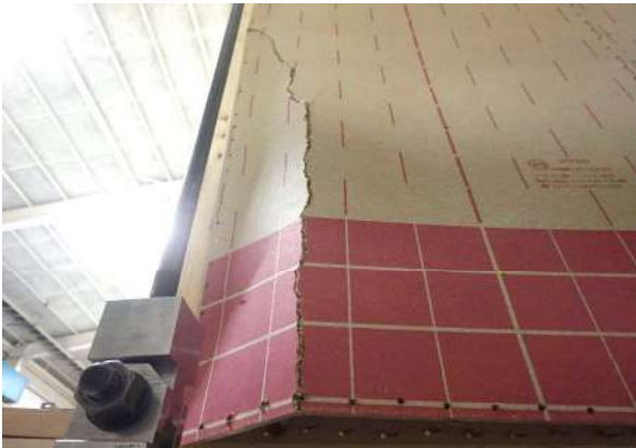
ウラ側面材脚部 面外への曲げ破壊
