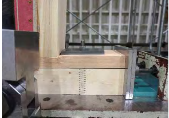
右柱脚部 下枠へのめり込み
