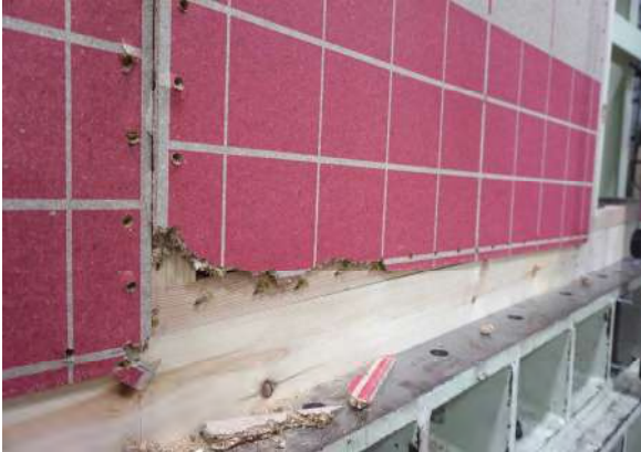
オモテ側面材継手部 面材の縁切れ
