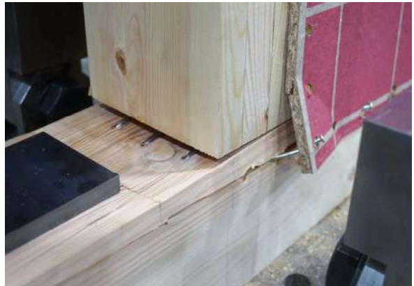
左柱脚部 枠組くぎの引抜け
