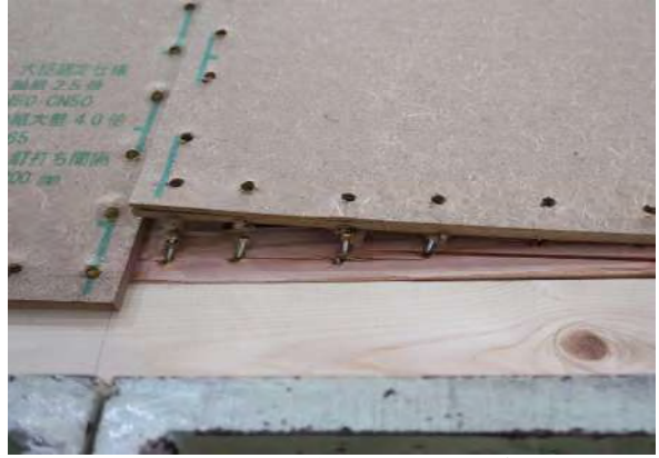
右面材オモテ側 面材くぎ頭のパンチングアウト
