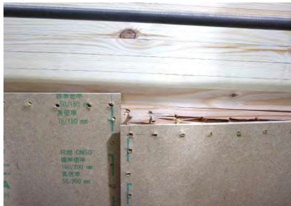
左面材ウラ側 上枠の割裂
