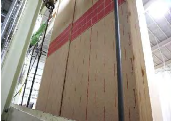
ウラ側面材継手部 くぎ頭のパンチングアウト
