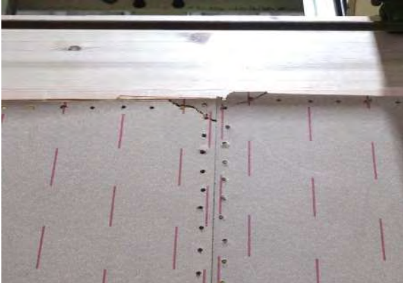
オモテ側面材継手部 角欠け
