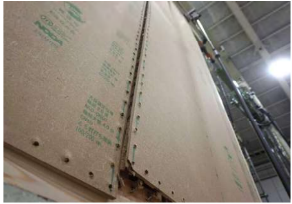
オモテ側面材継手部 面材くぎの引抜け
