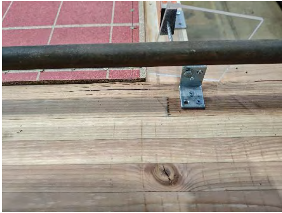
(7) 1/100rad 時 1層横架材表面剥離
