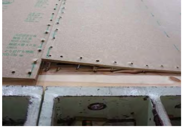
右面材オモテ側 面材くぎの引抜け
