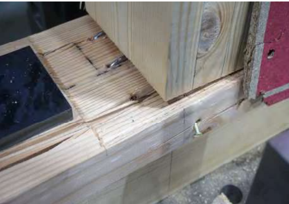
左柱脚部 枠組固定くぎの引抜け
