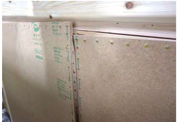
左面材ウラ側 頭つなぎと上枠の離間
