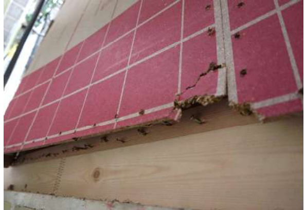
ウラ側面材継手部 面材くぎ頭のパンチングアウト
