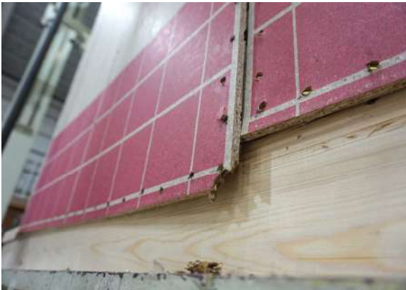
オモテ側面材継手部 面材の縁切れ
