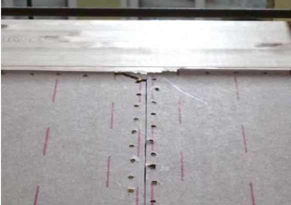
オモテ側面材継手部 面材の角欠け
