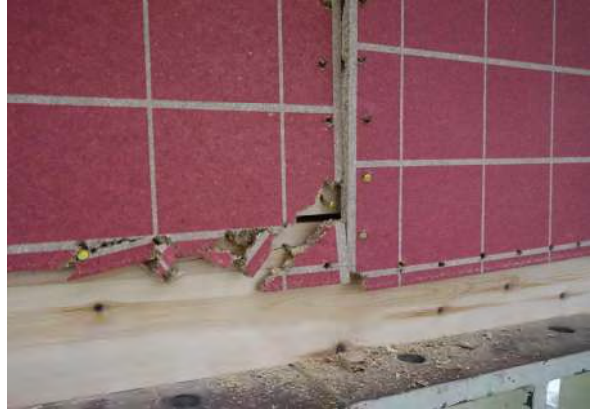
ウラ側面材継手部 面材の縁切れ
