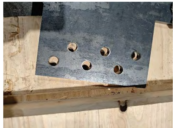
(6) めり込み箇所
