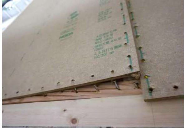
右面材ウラ側 下枠の割裂
